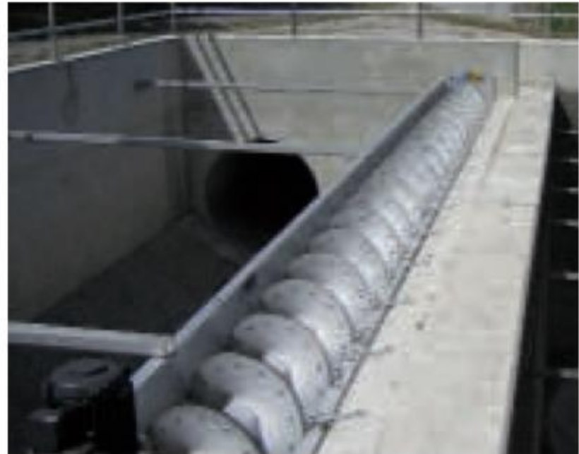
Tamiz para tormentas ROTAMAT® RoK 1 instalada en el lado seco del aliviadero de rebalse
